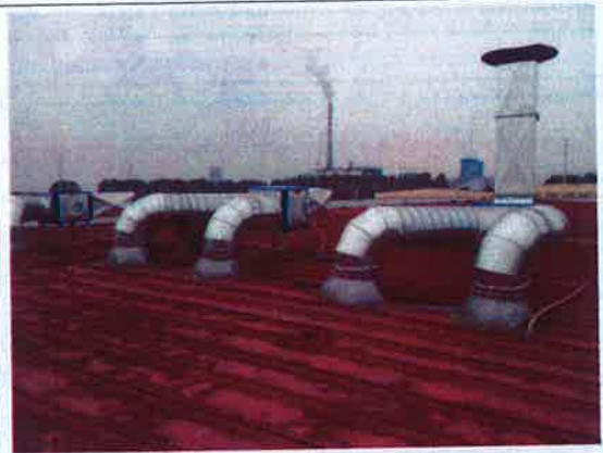
酱料车间油烟净化装置
